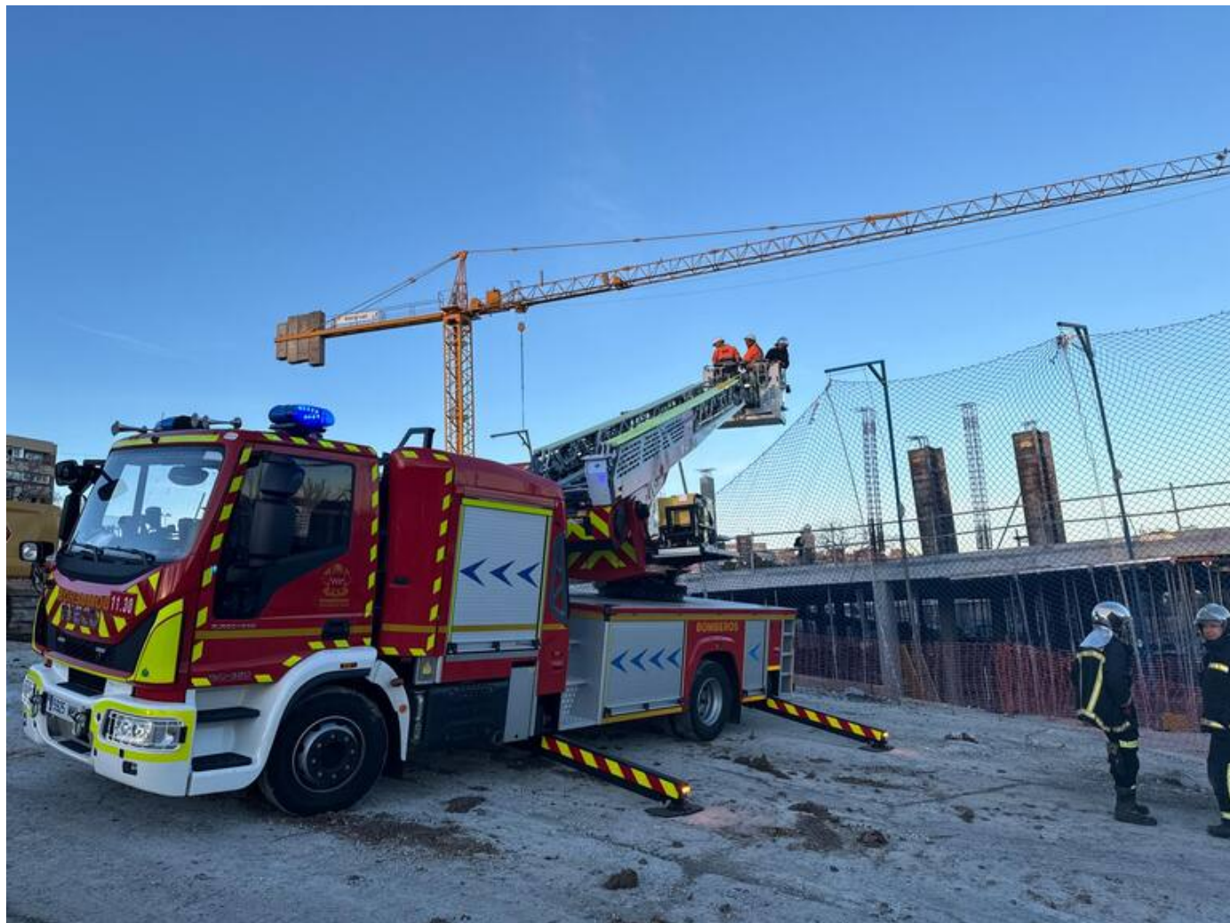
Se derrumba el forjado de las obras de construcción de un aparcamiento público en Alcobendas
